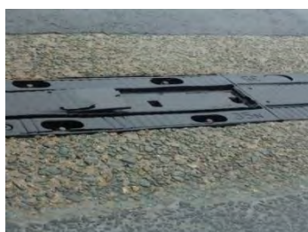
伸縮継手の損傷事例 （ゴムのはがれ）
