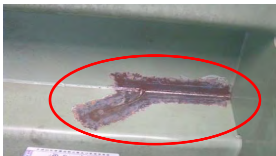
鋼床版 き裂状況
