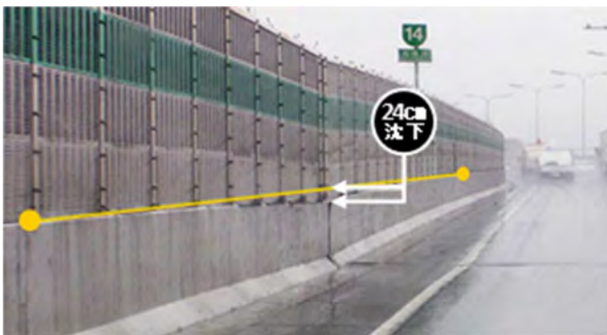
橋桁中央部の沈下状況
