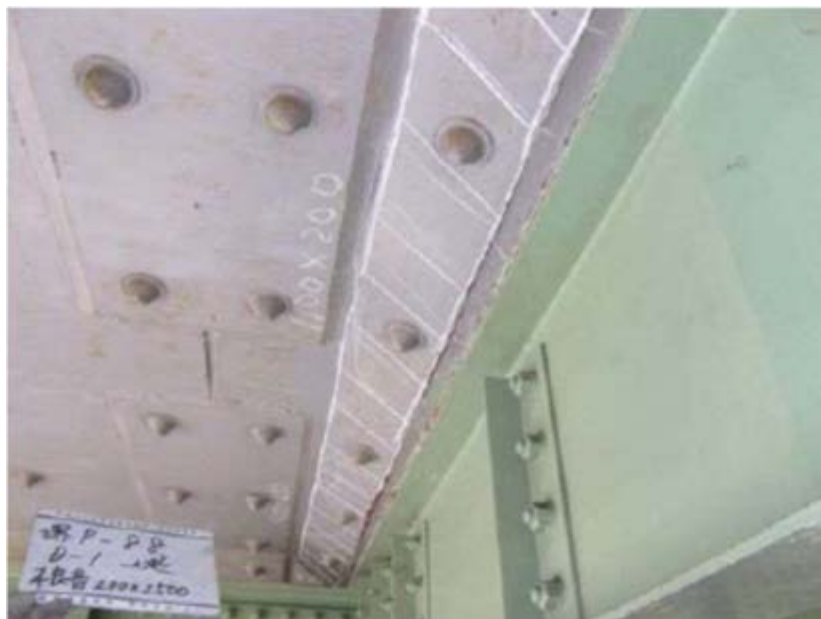
鋼板補強されたRC床版端部で不良音が確認
