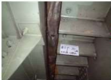
伸縮装置の損傷(止水破損)
