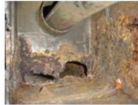
鋼製高欄部の損傷 (漏水による腐食)
