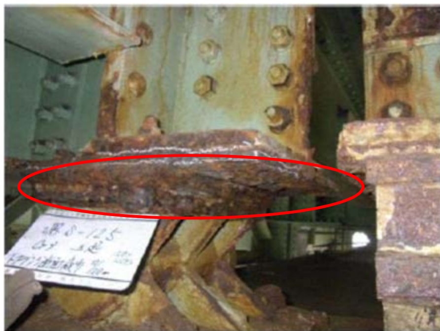
主桁端部下フランジの断面減少
