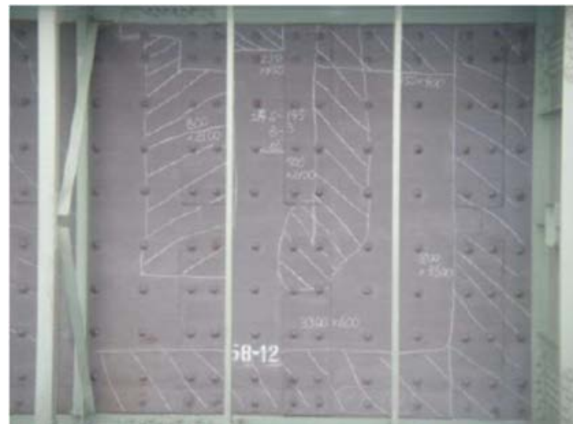
鋼板補強されたRC床版で不良音 が確認された部位のチョーキング
