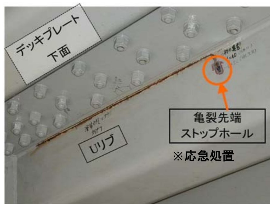
鋼床版のデッキプレートとUリブ 溶接部のき裂
