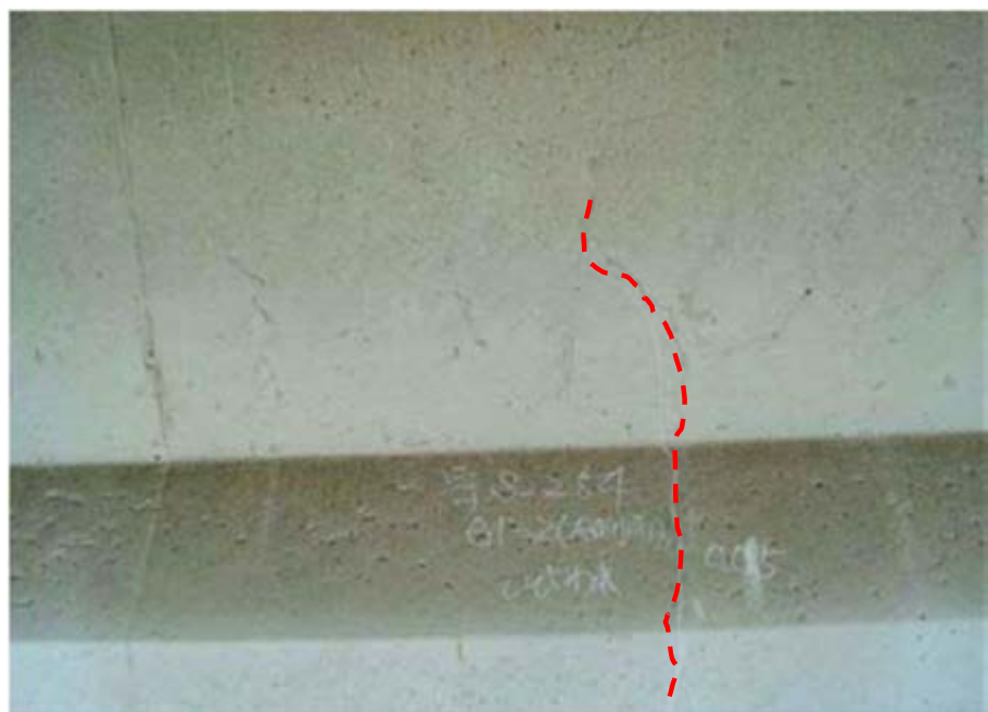
主桁のひびわれ
