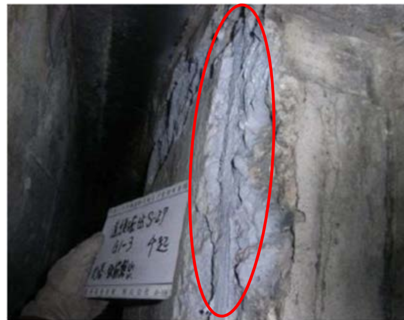
主桁の鉄筋露出
