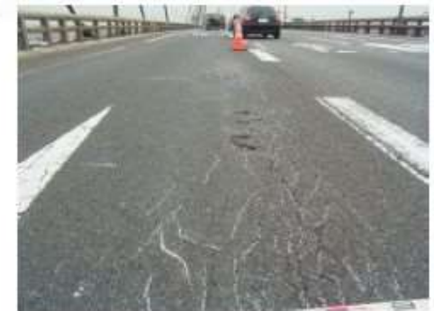
舗装の損傷(ひび割れ)
