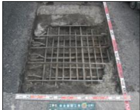
床版コンクリートの陥没
