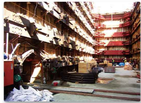
▲ 南海本線交差部《南海電鉄(株)が施工》 トンネルを押し込む際に必要な、ガイド導坑(レールを設置する坑)を掘っています。
