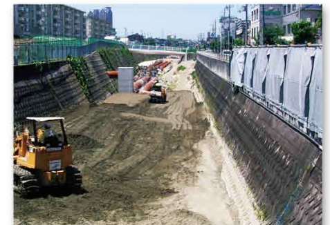
▲東浅香山町《常磐浜寺線西側》 西除川の水を流すための鋼管を設置しながら、川の埋立て作業を進めています。
