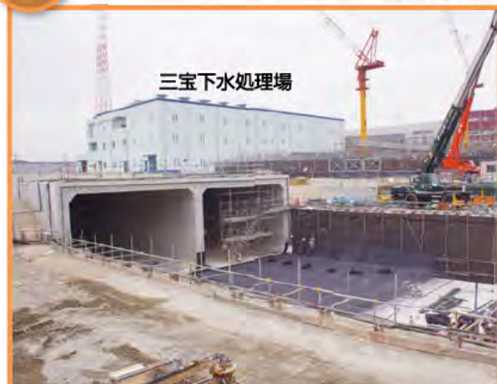
下水処理場北側で、トンネル建設が進んでいます。写真手前では、トンネルの底部分を作るための鉄筋が組まれています。
