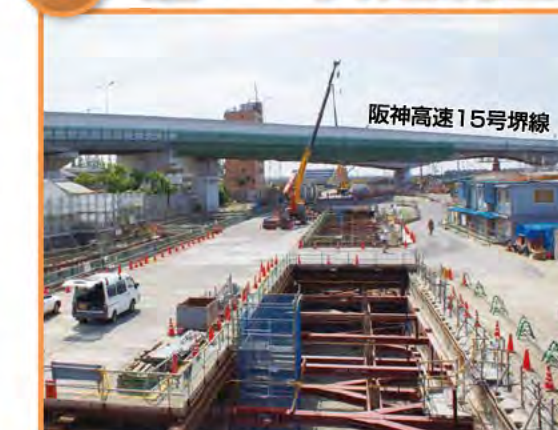
阪神高速15号堺線の下では土留壁の工事を終え、トンネル構造物を造るため地面の掘り下げを行っています。
