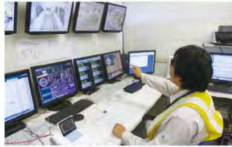
シールドマシン中央監視室
