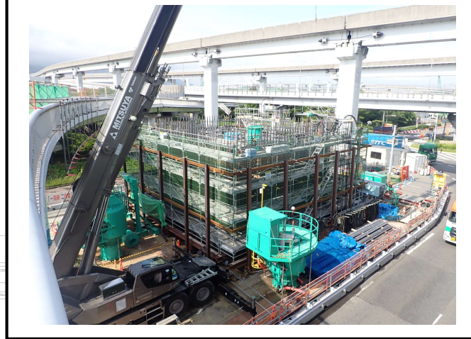
【2】高速道路の橋脚(PPE-7)ニューマチックケーソン基礎工事に於いて、2ロット目の鉄筋組立中。
