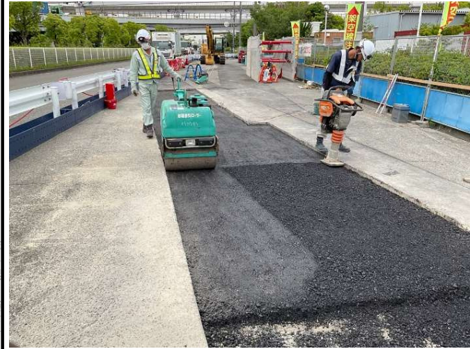
②雨水排水管を新設した後の表面部分(舗装)を復旧しています。(PPE-5付近)
