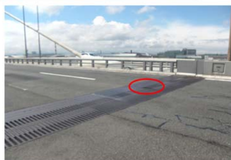
斜張橋の伸縮装置の損傷事例(大和川橋梁のフィンガー)
