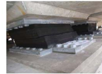
東日本大震災時の損傷(破断)
