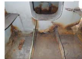
桁端部の損傷(東神戸大橋)
