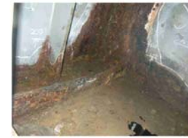
桁端部の損傷(大和川橋梁)
