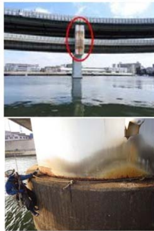
海上橋脚の損傷事例(鋼製)
