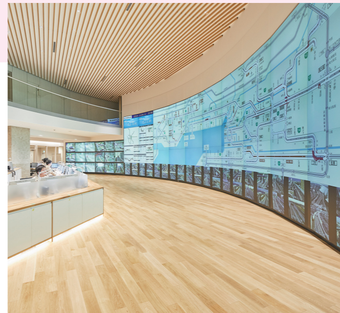
交通管制室(大阪)
