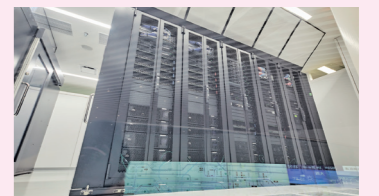
コンピュータ室
