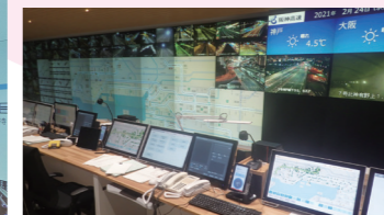
交通管制室(神戸)
