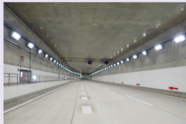
LED道路照明
