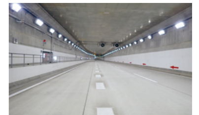
LED道路照明
