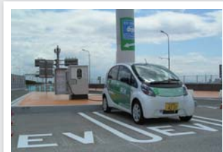
中島PAに急速充電器を設置(2009年)
