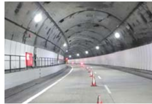
トンネル内LED道路照明
