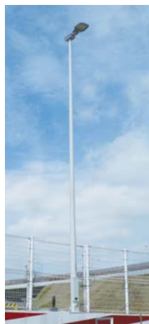
高架用LED道路照明
