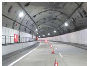
トンネル内LED道路照明
