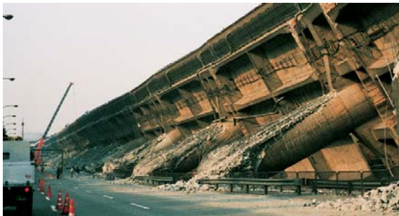
倒壊した高速道路
