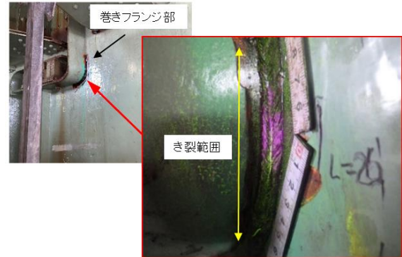
写真-1 ゲルバー支承の巻きフランジ部に発生したき裂
