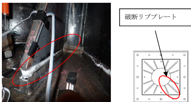
写真-3 テレビ支柱（ベースプレート拡幅） 最大荷重時（ 13\delta y ）基部（引張側）
