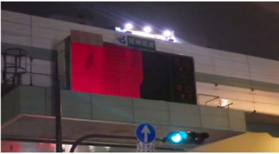
図-1 道路情報板異常点灯状態
