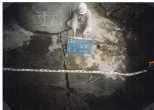
図-1 C ランクの損傷が生じたフーチング
