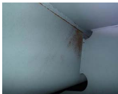
写真-2 「さび」損傷事例
