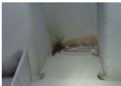
写真-1 「変色」損傷事例
