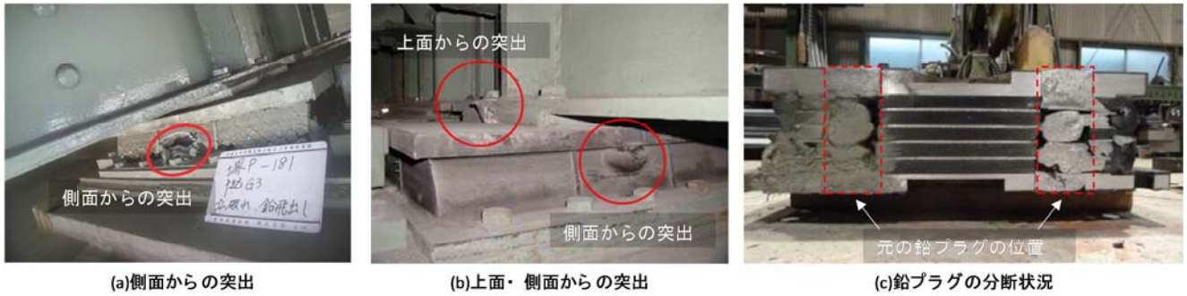
写真-1 鉛プラグ入り積層ゴム支承の変状
