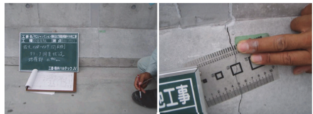
写真-1 高欄ハンチ部のひび割れ状況 (守口 JCT 実績)
