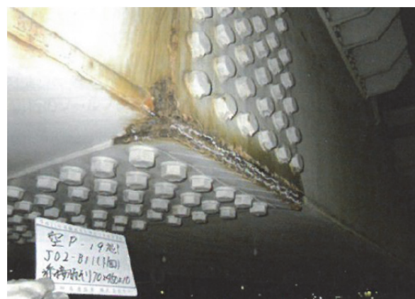
図-6 添接板端部の腐食
