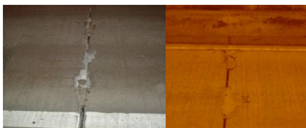
写真-5 目地部の損傷写真
