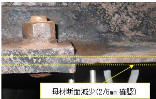
写真-1 側縦桁下フランジ断面減少状況
