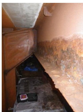
写真-2 側縦桁の腐食状況例
