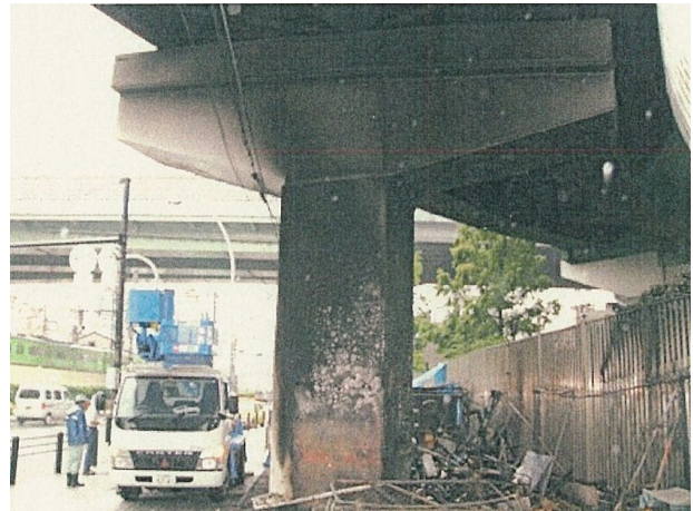
写真-1 天王寺出路 P-3 の被災状況
