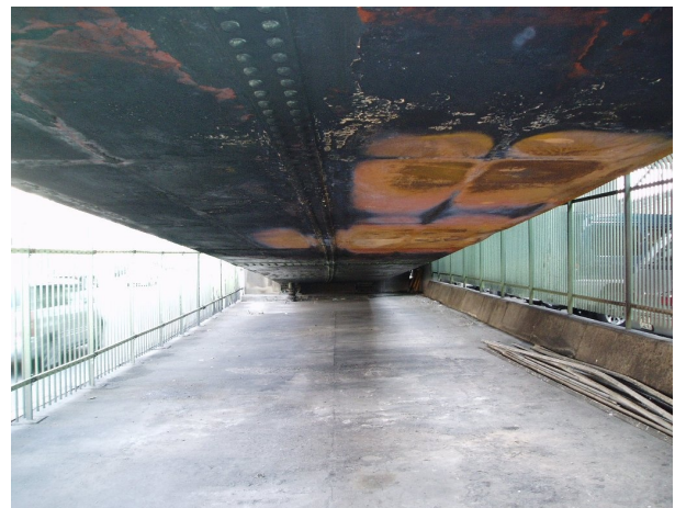
写真-2 波除出路 S-5 の被災状況
