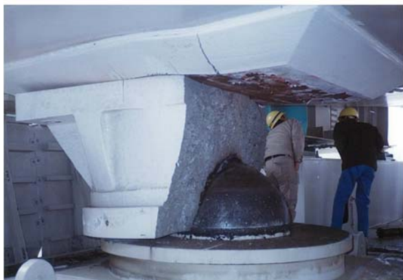
図-2 固定側(海 P100 側)支承の損傷
