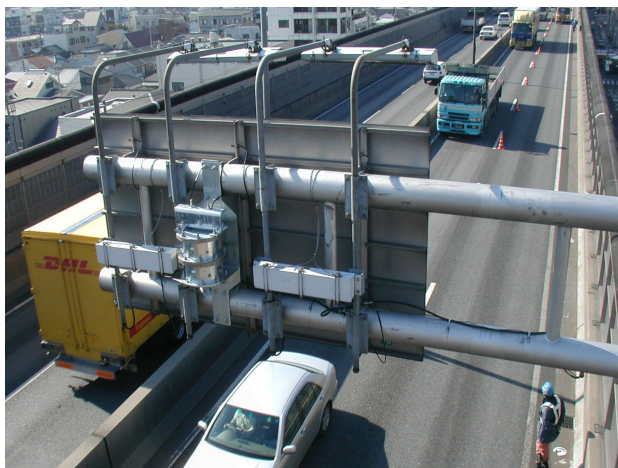
図-7 TMD 設置状況写真
