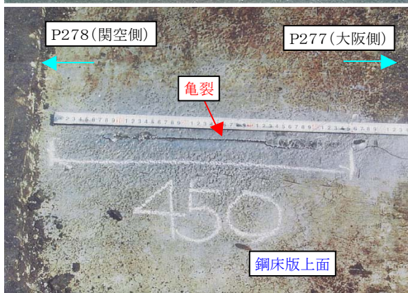
写真-1 損傷写真（デッキ表面）
