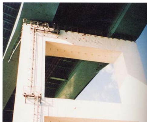
写真-1 鋼製橋脚の上段はりウェブのせん断座屈の例
