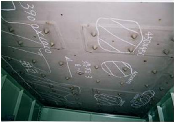
写真-1 不良音の事例（斜線部が不良音範囲）
