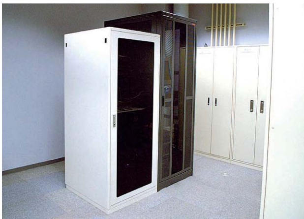
写真-1 サーバマシン
