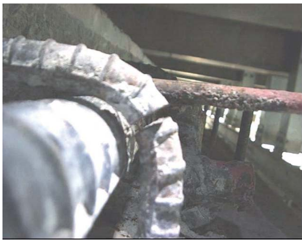
写真-3 鉄筋損傷（スターラップ破断）状況
