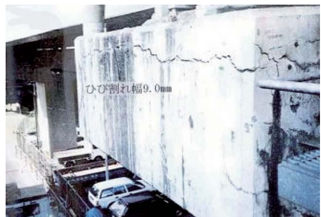
写真-1 橋脚梁部のひび割れ状況の例
