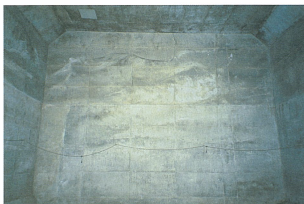
写真-5 後防水漏水状況 (終点側：合成ゴムシート)
