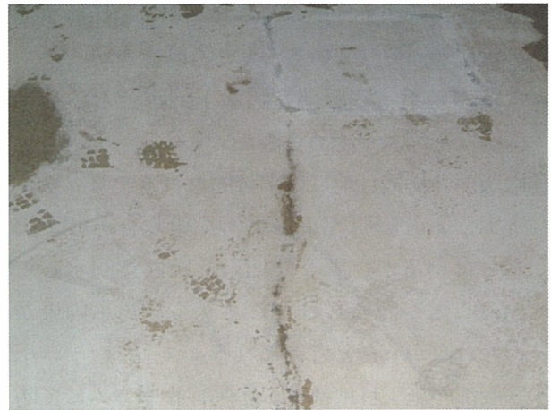
写真-7 漏水状況（底版クラック部）
