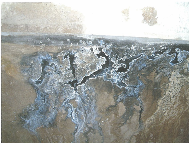
写真-5 漏水状況（構造目地部）
