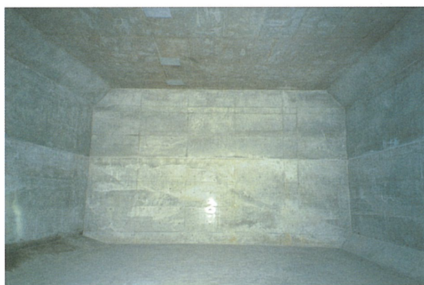
写真-4 後防水漏水状況 (起点側：ゴムアスファルトシート)
