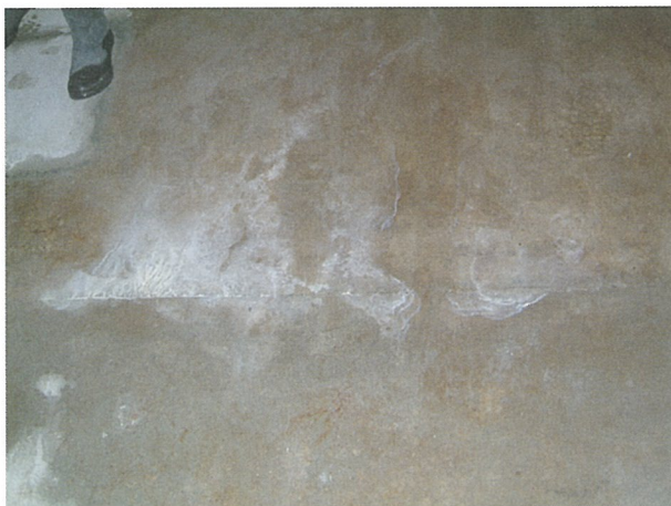
写真-6 漏水状況（施工目地部）
