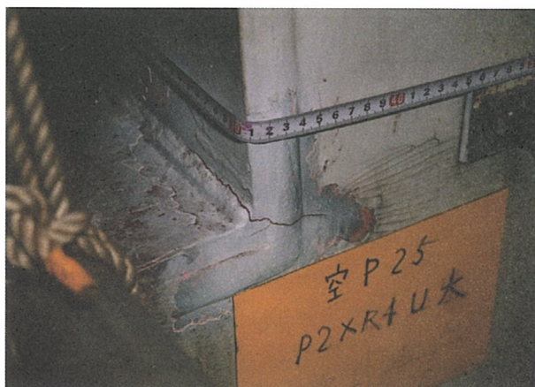
写真-1 空P25亀裂写真
