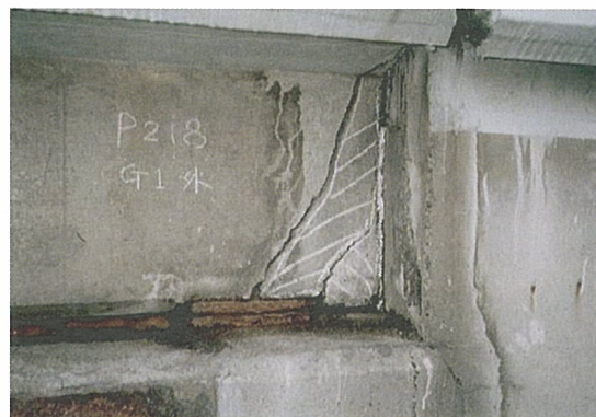
写真-1 損傷状況（環S-218）
