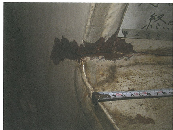
図-12 大P88 損傷状況（目視点検）
