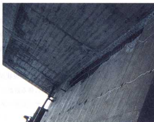
写真-1 橋脚頂部の損傷状況 (P443)
