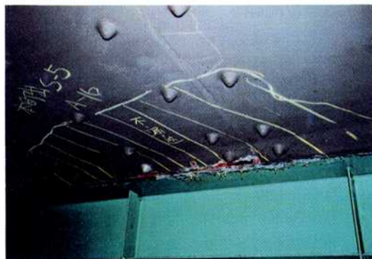
写真-1 損傷状況 (P5～P6)
