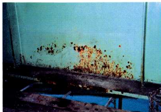
写真-2 損傷状況 (P5～P6)
