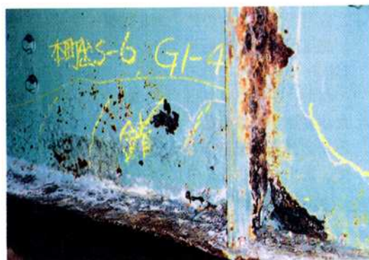
写真-3 損傷状況 (P6～P7)
