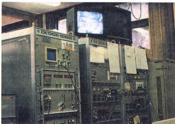
写真-2 計算機と制御装置
