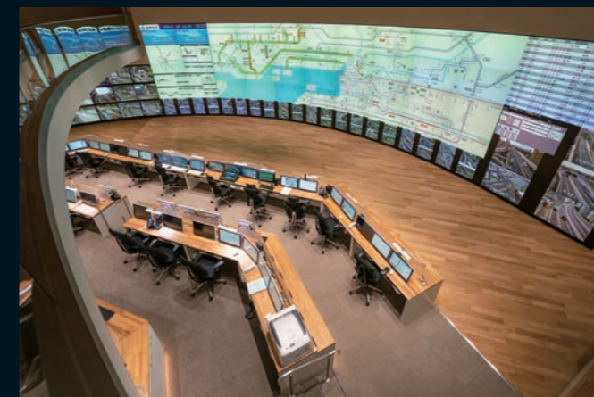
朝潮橋交通管制室(左) / 朝潮橋設備監視室(右)
