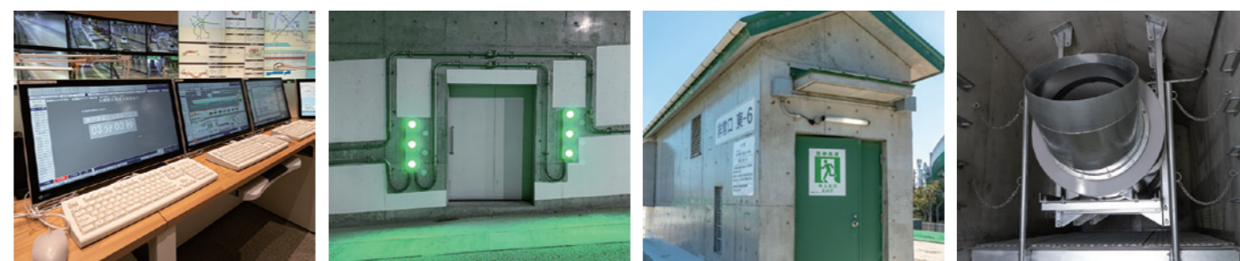
トンネル防災中央 非常口(トンネル側) 非常口(地上側) 非常階段ファン
