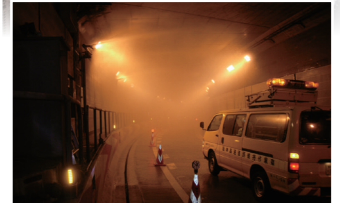
水噴霧放水試験
