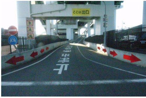
高欄側面矢印表示、路面表示の設置 (5号湾岸線 深江浜(東行)出口)
