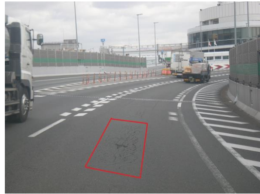
16号大阪港線：舗装穴
