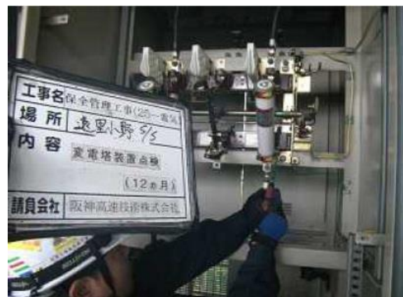
受変電設備点検
