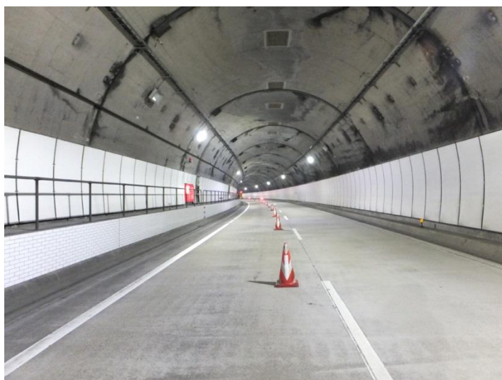
道路トンネル照明 (LED)
