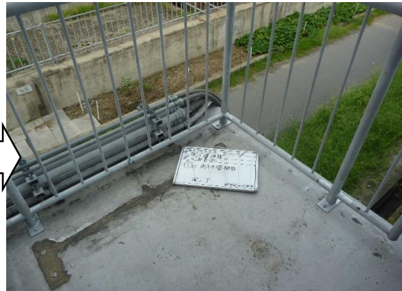
料金所張出部手摺足下腐食（補修後）
