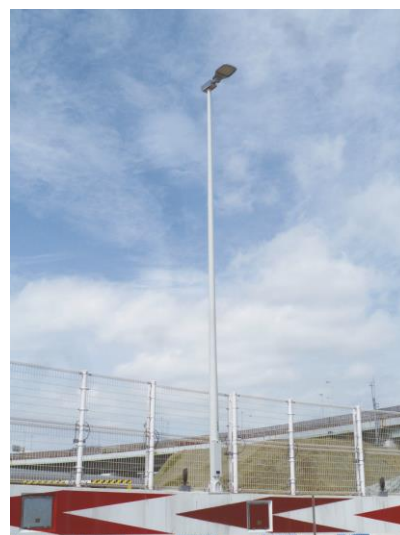
明かり部道路照明 (LED)
