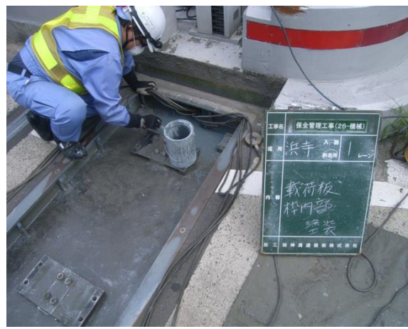
軸重計定期点検
