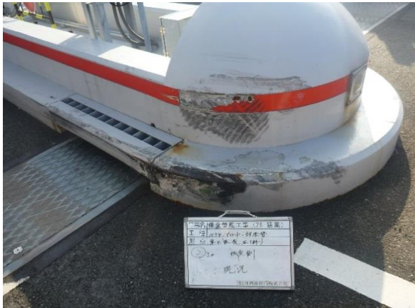
料金所アイランドバリヤ車両接触（補修前）
