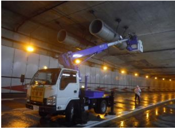
トンネル換気設備
