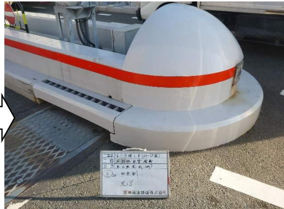
料金所アイランドバリヤ車両接触（補修後）
