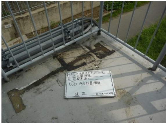
料金所張出部手摺足下腐食（補修前）
