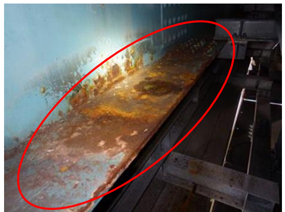
3号神戸線：主桁下フランジ断面減少
