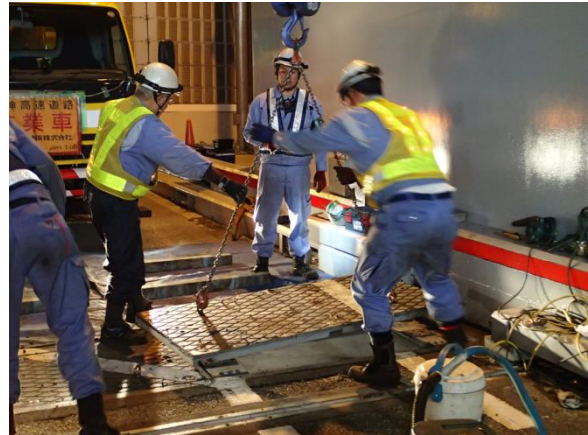
軸重計測設備
