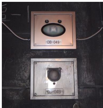
火災検知器 (上：新、下：旧)
