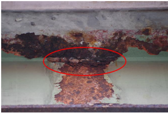
12号守口線：さび片の落下恐れ
