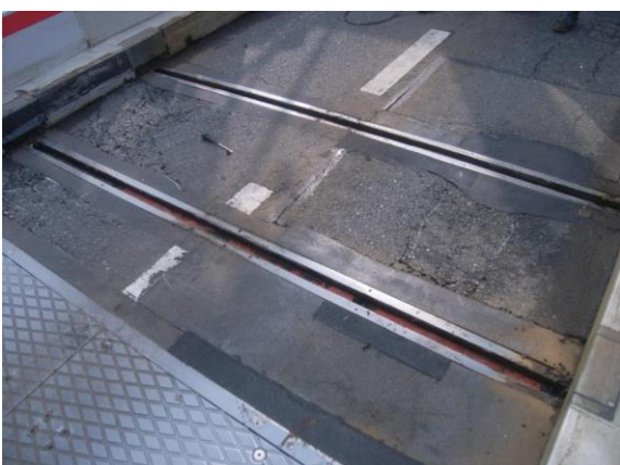
軸重計棒状センサー補修前
