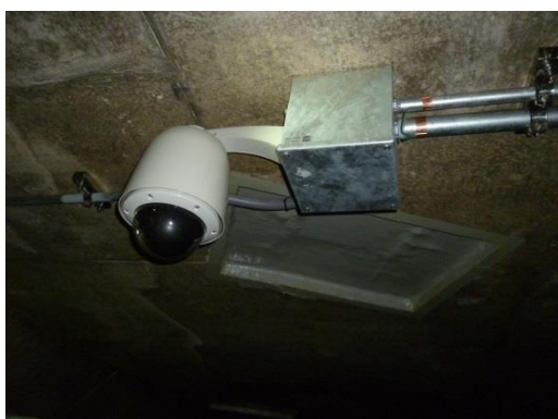
ポンプ場内監視カメラ装置
