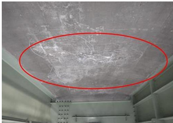
3号神戸線：床版ひびわれ
