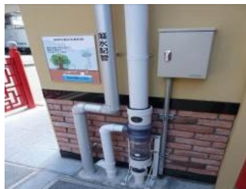
雨水再利用設備
