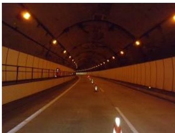
トンネル照明(ナトリウム灯)更新前
