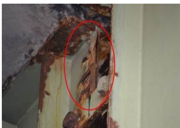
11号池田線：さび片の落下恐れ
