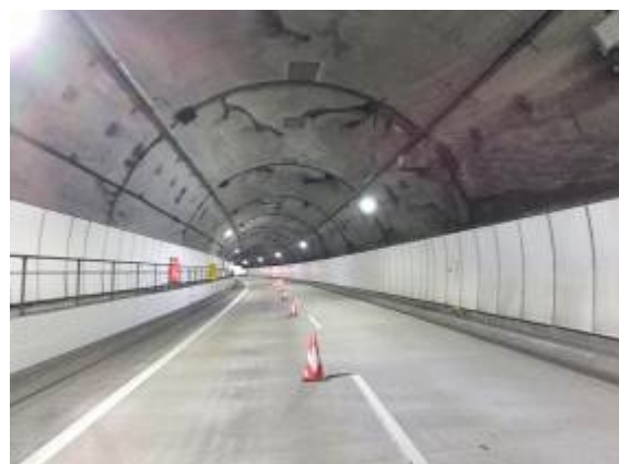
トンネル照明(LED)更新後
