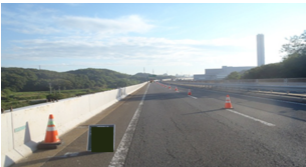
路面損傷状況(施工前)
