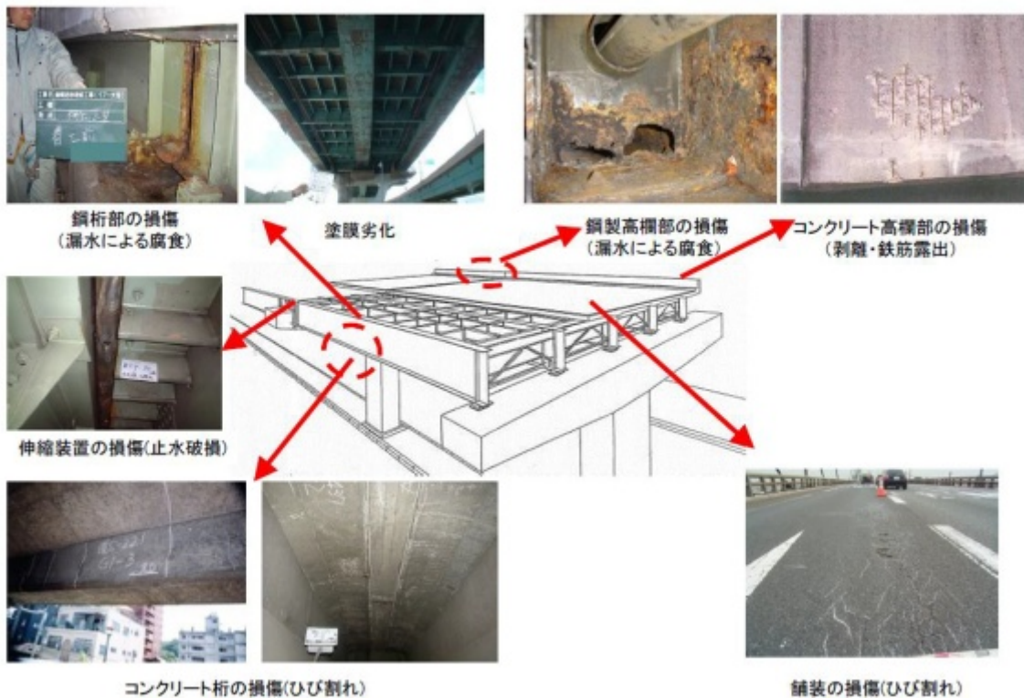
道路の損傷状況の写真
