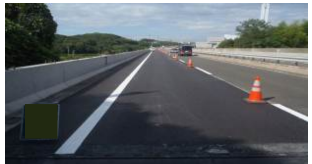
路面損傷状況(施工後)
