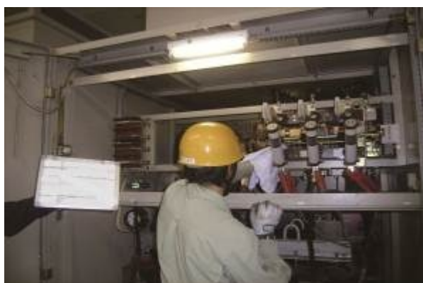
定期点検（受電所）
