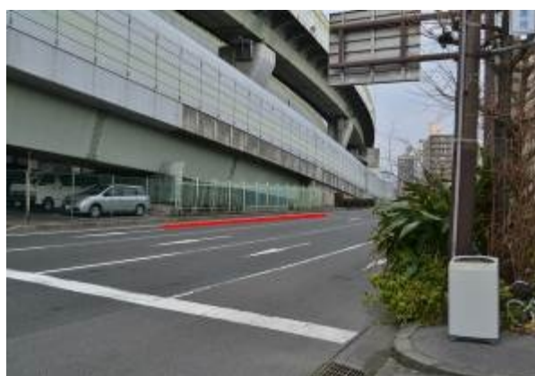
16号大阪港線：立入防止柵の腐食
