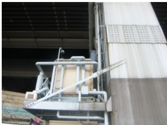
給水設備 取替前
