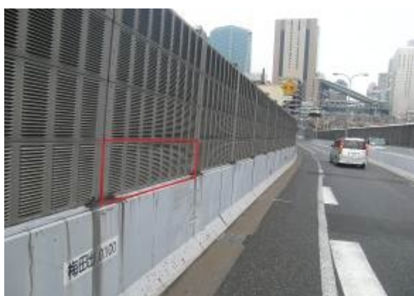
11号池田線：遮音壁の損傷
