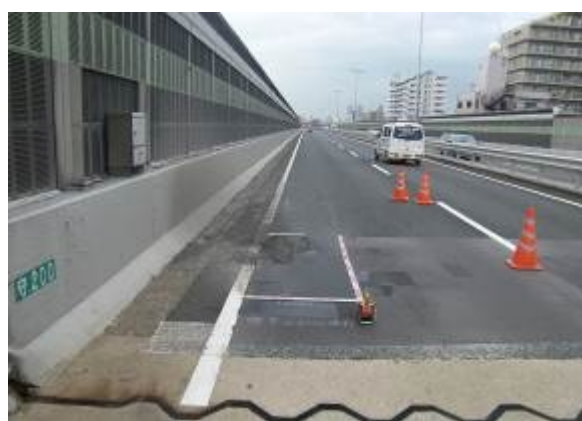
12号守口線：舗装穴
