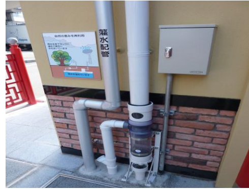
雨水再利用設備
