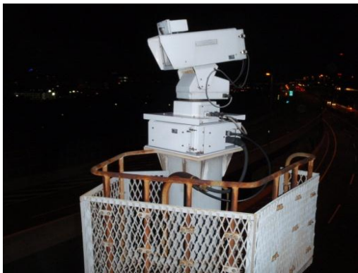
交通流監視カメラ更新前
