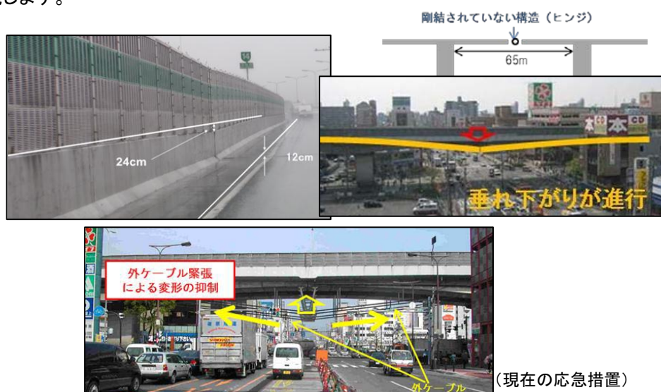
《大規模更新実施箇所における損傷事例(14号松原線喜連瓜破付近)》
