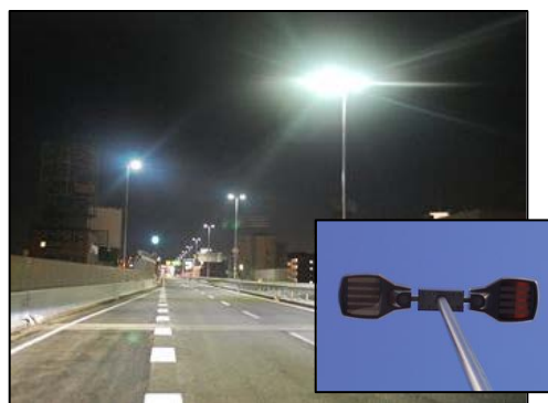
《道路照明の全線LED化》
