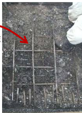
床版内部の損傷(砂利化)
