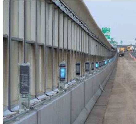
速度回復誘導灯の設置状況
