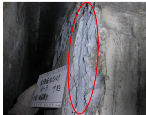
主桁の鉄筋露出
