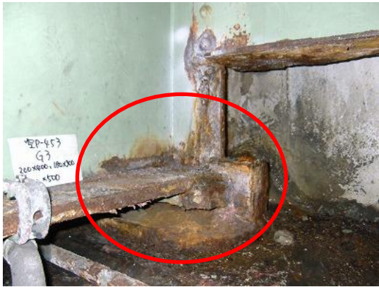
鋼桁端部の腐食による断面減少
