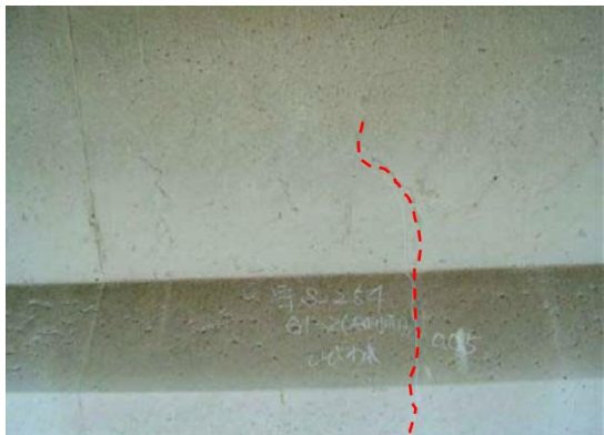
主桁のひびわれ
