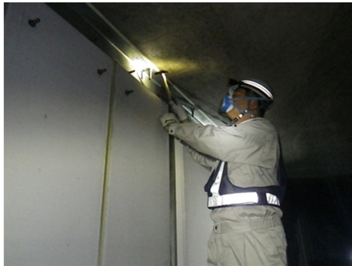
天井板を支持する鋼材及びボルトの点検
