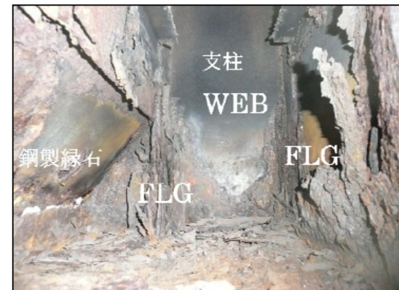
腐食損傷内部
