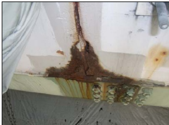
腐食損傷外観
