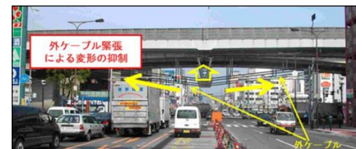
大規模更新実施箇所における損傷事例
