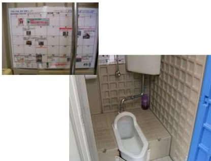
● 仮設トイレの好例
